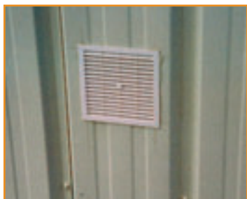
Ouïes d'aération pour ventilation statique
