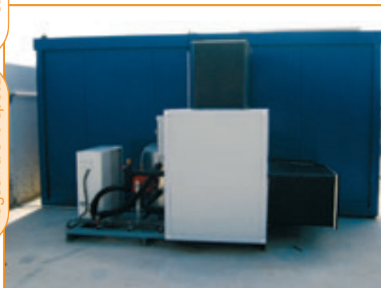
Vue d'ensemble du groupe de climatisation réversible avec les gaines de reprise et de diffusion
