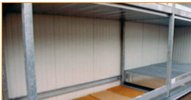
Complément d'isolation laine de roche sur armoires
